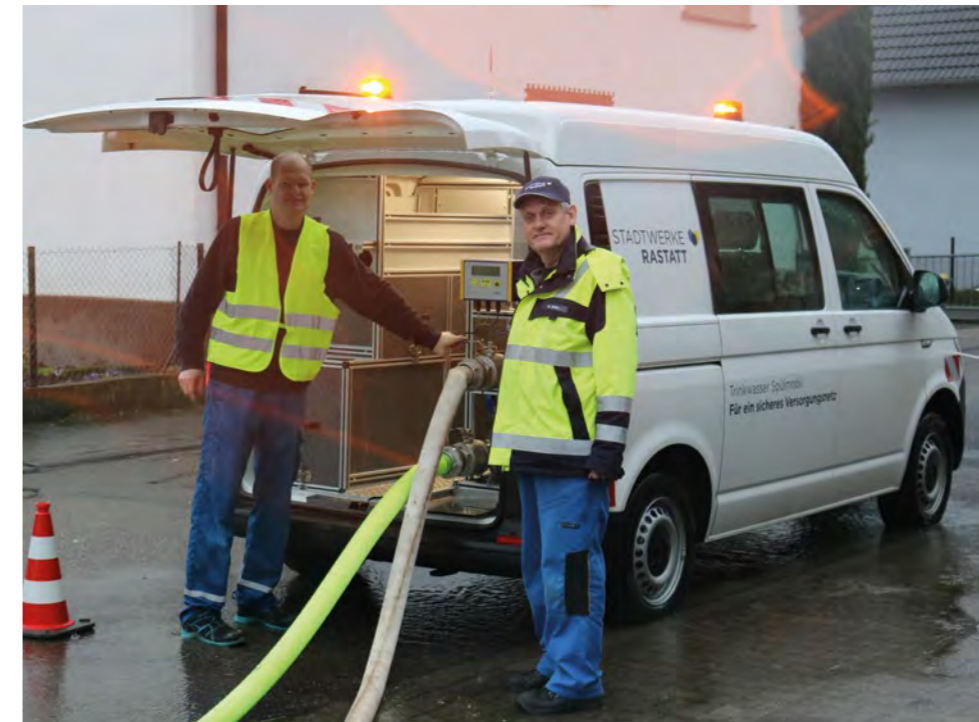
Rastatt spült Unser 2020 angeschafftes Spülmobil hält unsere Trinkwasserleitungen sauber.
